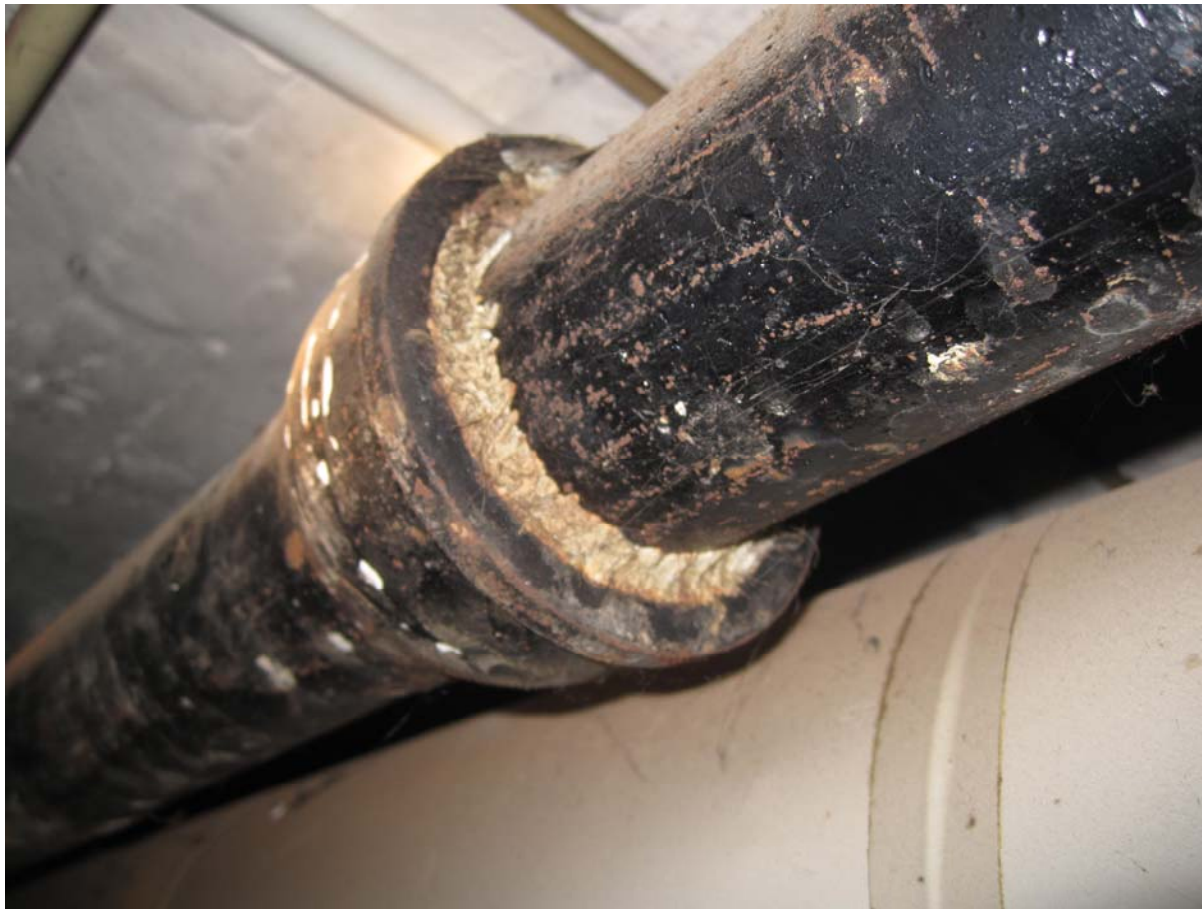
Asbestdichtschnüre im Muffenbereich von Abwasserleitungen (oft gemeinsam mit Teerpech)
