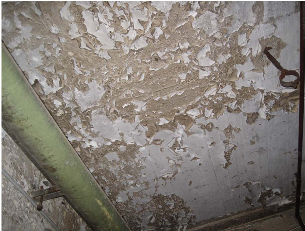
Asbest in Beschichtungen und Farben
