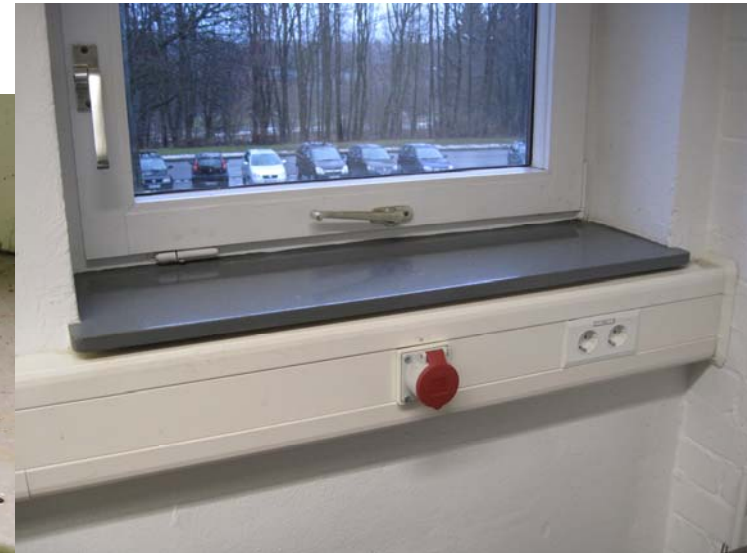
Fensterbank aus Asbestzement
