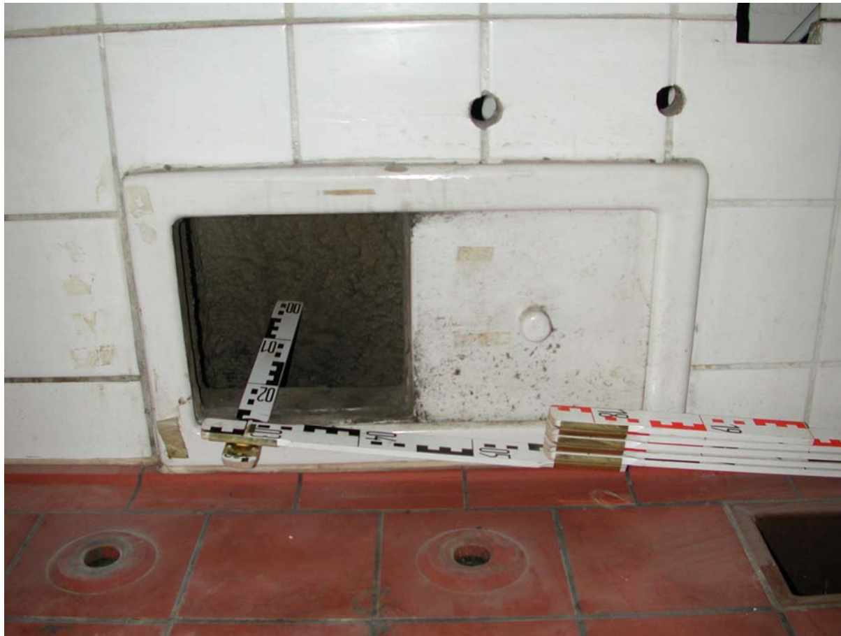
Wände und Abluftschacht von alten Laborabzügen aus Asbestzement
