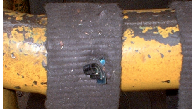
Bild 4-4: Durch heißen Span beschädigte Oberfläche
