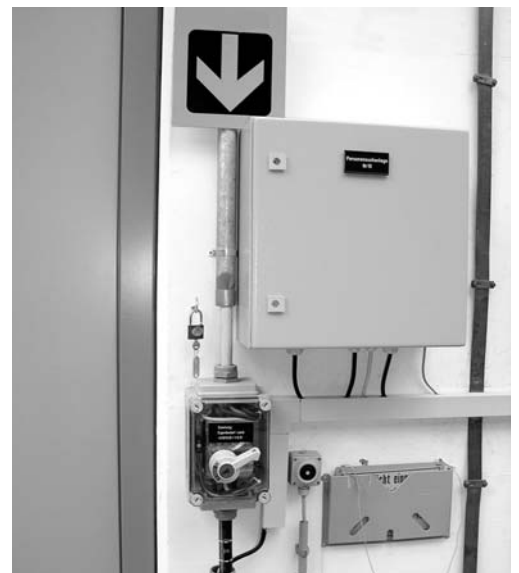
Bild 5: Anlageschalter (Kranschalter), der in der ausgeschalteten Stellung mit einem Vorhängeschloss gegen Einschalten gesichert werden kann.
