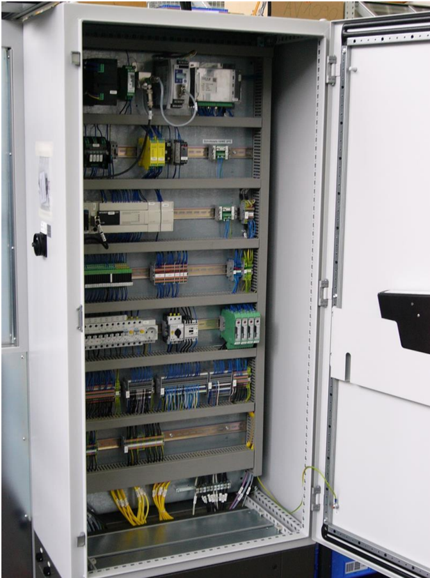
Bild 11: Geöffneter Schaltschrank eines Prüfstands
