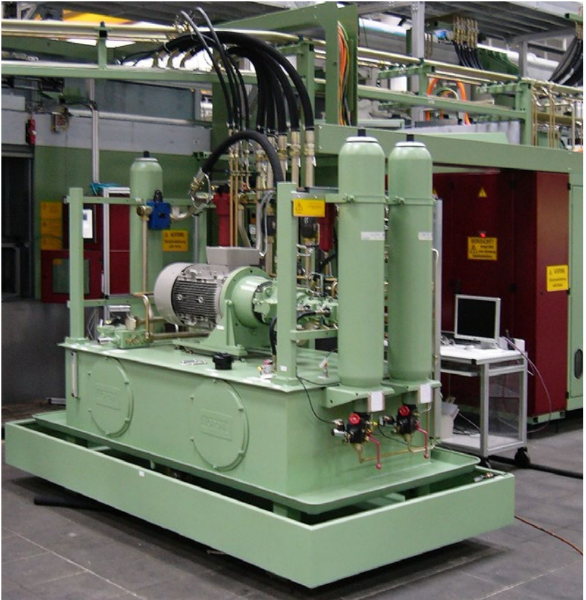
Abb. 24 Hydraulikaggregat an stationärer Produktionseinrichtung
