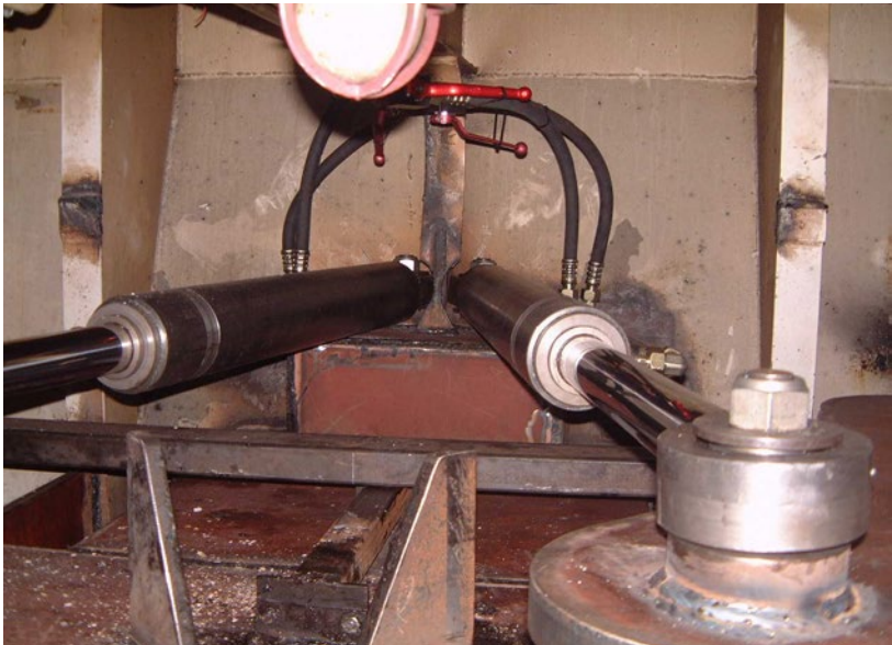
Abb. 43 Quetschgefahren an einer Ruderanlage
