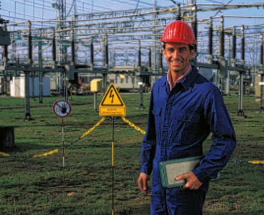
Gute Kennzeichnung der Arbeitsgrenzen in einer 110-kV-Freiluft-Schaltanlage
