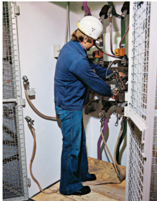
Einlegen der Erdungs- und Kurzschließvorrichtung in einer Mittelspannungsschaltzelle
