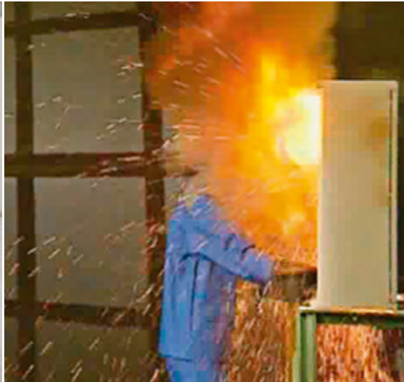
Lichtbogen beim Ziehen von NH-Sicherungen
