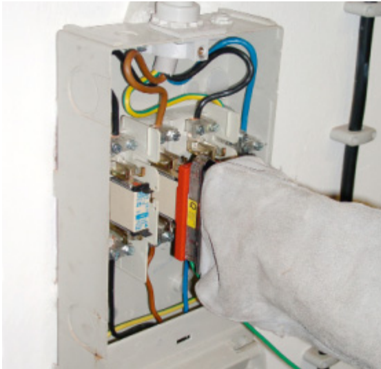
Ziehen eines NH-Sicherungseinsatzes
