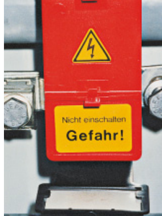
Eine wirkungsvolle Kennzeichnung kann die Gefahr eines „versehentlichen“ Wiedereinschaltens abwenden
