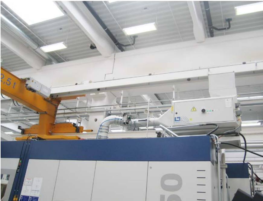
Abb. 8 Luftabsperklappe, Löschdüse und Strömungssensor
