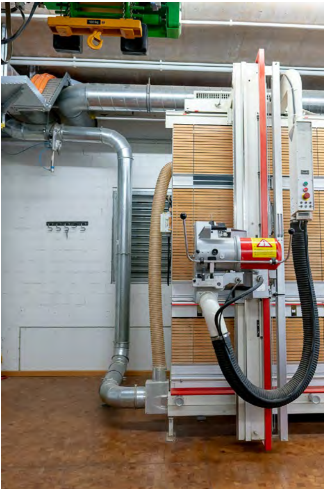
Abb. 3.1.2-07 Absauganlage an einer vertikalen Plattensäge
