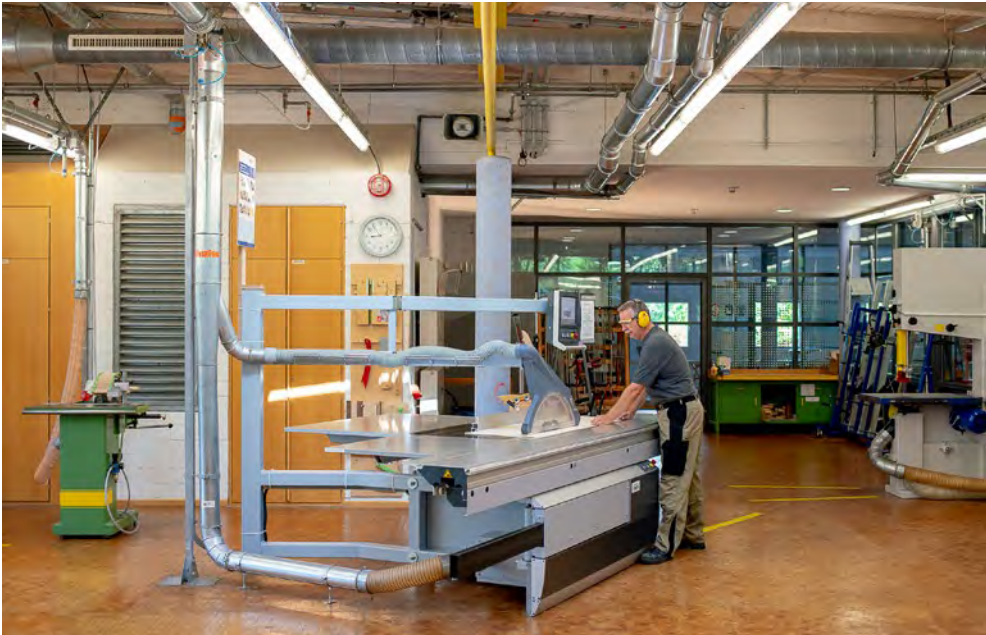
Abb. 2.2.3-01 Absauganlage an einer Holzbearbeitungsmaschine
